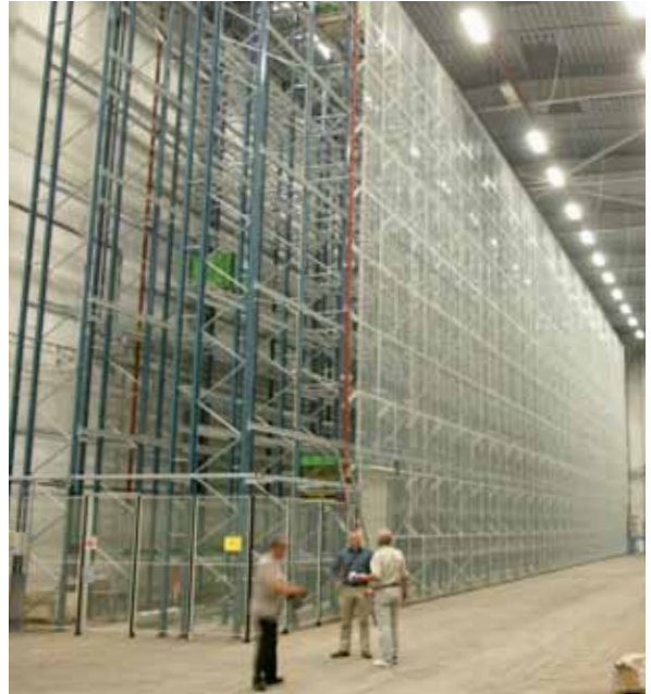
SafeStore von AXELENT, Maschenweite 50x60 mm. Die abgebildete Anlage wurde bei Sapa Arendal, einem Zulieferpartner von Volvo, installiert.
